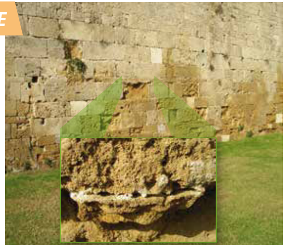
Повреждения от солей при капиллярном подгосе
